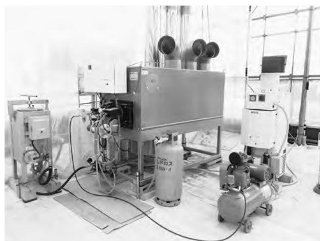
ビニールハウスを温めるボイラー
