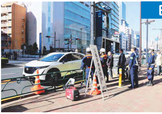
EVを使って信号へ給電した
